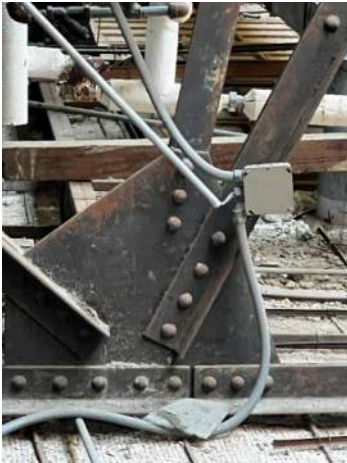
XE.22 Broken Conduit System
