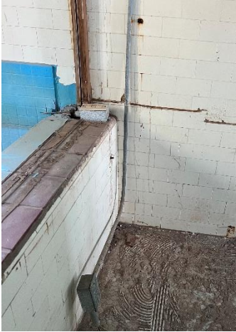
XE.13 Open Wiring
