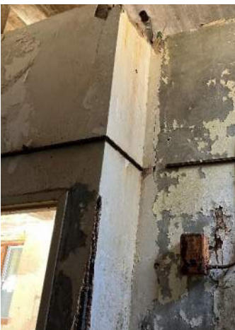
XE.6 Existing Conduit System
