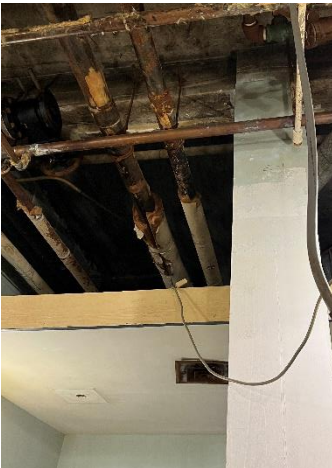
XE.14 Open Wiring
