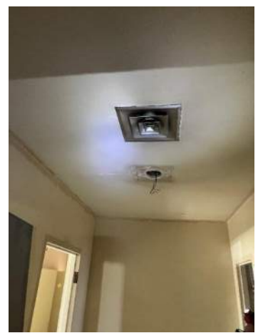
XE.12 Open Wiring
