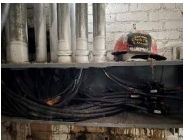
XE.2 Basement Wireway
