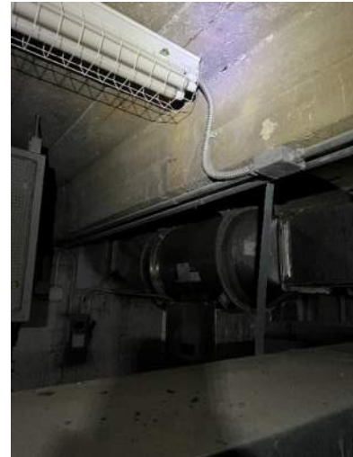
XM.5 Crawlspace Exhaust Fan
