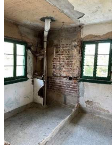
XE.31 Rusted Conduit
