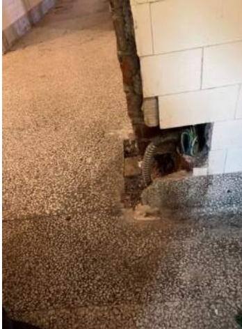
XE.12 Open Wiring
