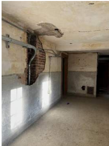
XE.10 Existing Damaged Conduit
