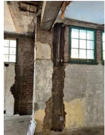
XE.32 Rusted Conduit
